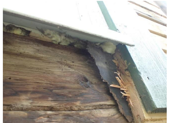
Kuva 37 Ikkunan alapuoleisissa hirsirakenteissa on havaittavissa kosteuden aiheuttamia jälkiä ja mineraalivilla ulkoseinän ikkunaliittymässä on tummuntta.
