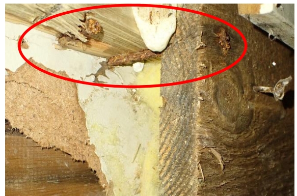
Kuva 41 Läpiruostuneet naulat takkahuoneen 101 ulkoseinässä ikkunan alapuolella viittaavat siihen, että rakenne on ollut toistuvasti kostea.
