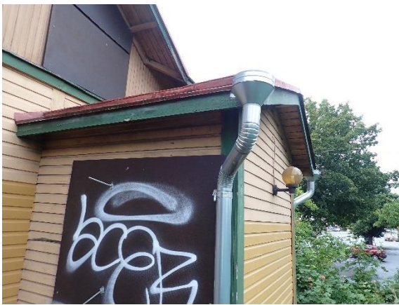
Kuva 9 Vesi ohjautuu jalkaränneistä syöksytorviin, jotka ovat hyväkuntoiset.
