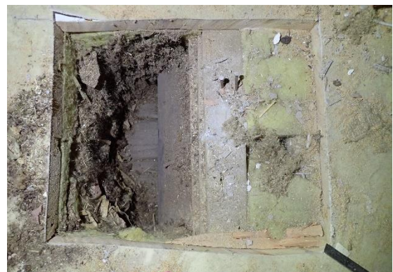
Kuva 53 Keittiön välipohjan (VP2) eristetilassa on mineraalivillaa, tiilenkappaleita, sanomalehtiä ja turvetta. Eristetilan alla on aluslaudoitus (ilman juuttikangasta).
