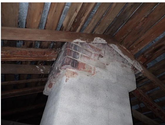
Kuva 66 Vesikatteen aluslaudoituksissa ja kannatinpalkkeissa on kosteuden aiheuttamia jälkiä ja näkyvää mikrobikasvua lähellä hormia.
