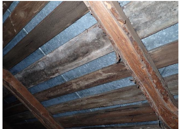
Kuva 69 Vesikaton lappeen aluslaudoituksissa on havaittavissa näkyvää mikrobikasvua.
