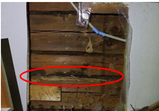
Kuva 40 Keittiössä 110 hirsiseinän sisäpinnassa on lahovaurioita toiseksi alimmassa vaakahirressä. Ulkoseinän rakennetyyppi on US2.
