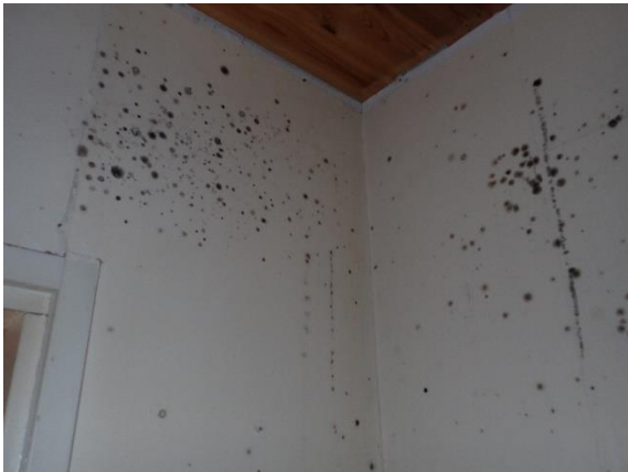
Kuva 58 1. kerroksen seinäpinnoilla näkyvää mikrobikasvua.
