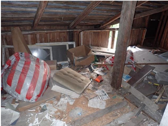
Kuva 70 Yläpohjan ryömintätallassa runsaasti erilaista jätettä.
