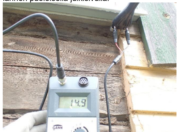
Kuva 47 Ikkunan alapuolisen hirren kosteuspuitoisuus etelän puoleisella julkisivulla.
