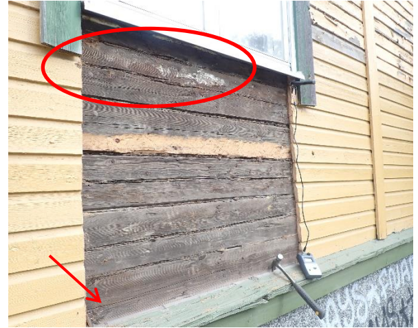
Kuva 33 Havaintojen mukaan hirressä on paikoin lahovaurioita ja kosteuden aiheuttamia jälkiä ikkunan alapuolisessa hirressä ja ulkoseinän alimmassa hirressä.
