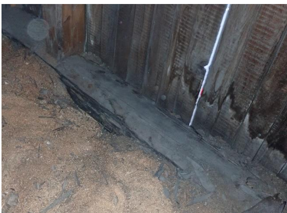
Kuva 72 Yläpohjan ulkoseinälinjalla sijaitsevan hirsirakenteen pinnalla on kosteuden aiheuttamia jälkiä.
