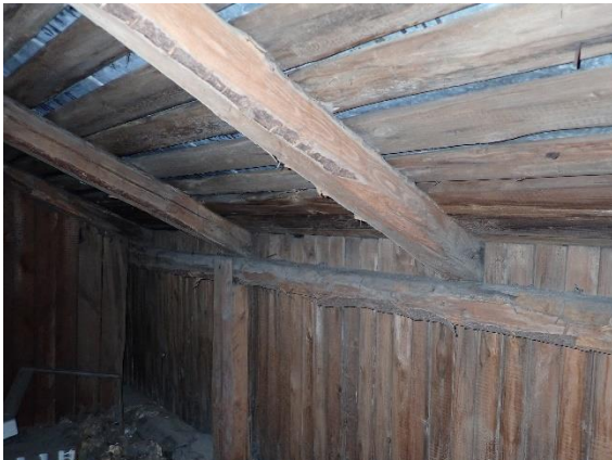
Kuva 68 Vesikatteen aluslaudoituksissa on kosteuden aiheuttamia jälkiä lähellä räystäitä.
