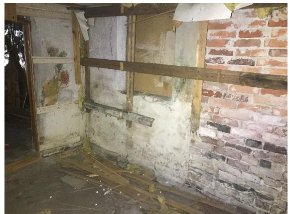
Kuva 21 Maanvastaisissa seinärakenteissa paikoin rapaus sekä puurakenteita. Ikkuna-aukkoja ummistettu (tila 002).
