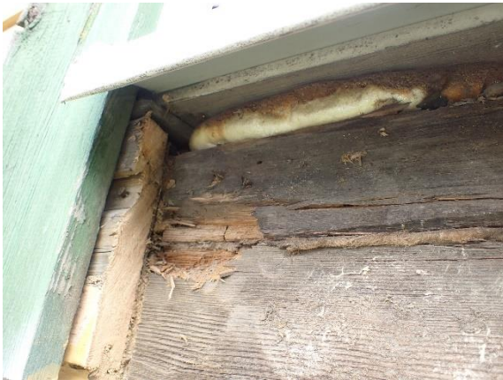
Kuva 42 Ikkunaliittymässä paikoin uretaanivaahdotus. Hirressä pinnallisia lahovaurioita.
