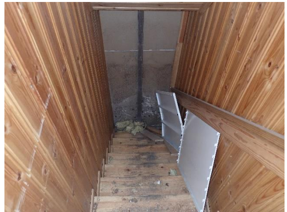
Kuva 57 Näkyvää mikrobikasvua kellariin johtavan portaikon ummistetun oviaukon takana.
