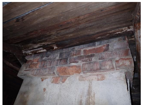
Kuva 67 Kannatinpalkkien ja aluslaudoitusten kosteusjäljet ja mikrobivauriot viittaavat vesikatteen vuotoon hormin kohdalla.
