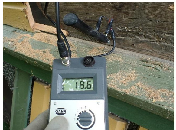
Kuva 45 Ulkoseinän alimman hirren kosteuspuitoisuus lännen puoleisella julkisivulla.
