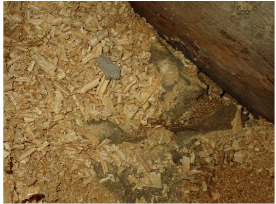
Kuva 71 Yläpohjan sahanpurun ja laudoituksen välissä havaittiin linoleumia, pahvia tai kangaskerros.
