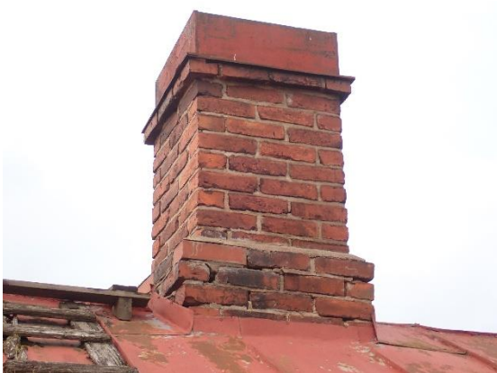
Kuva 64 Hormin alaosista tiilien saumalaastit ovat paikoin irronneet kokonaan.
