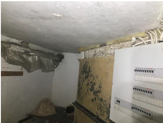
Kuva 56 Kellaritilojen väliseinäpinnoilla näkyvää mikrobikasvua.
