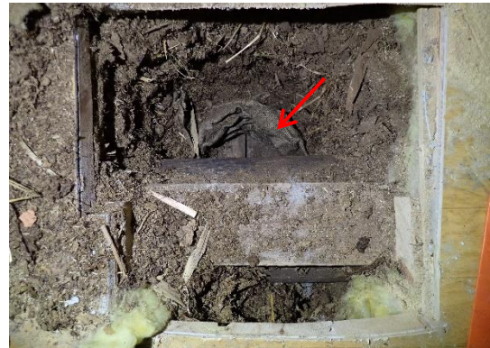
Kuva 49 Keittiön välipohjan (VP1) eristetilassa todettiin mineraalivillaa ja turvetta. Eristetilan alapuolella näkyvät juuttikangas ja aluslaudoitus.
