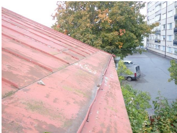
Kuva 60 Räystäällä on jalkarännit, joista vesi ohjautuu syöksyputkille.
