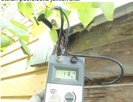
Kuva 46 Ikkunan alapuolisen hirren kosteuspuitoisuus lännen puoleisella julkisivulla.
