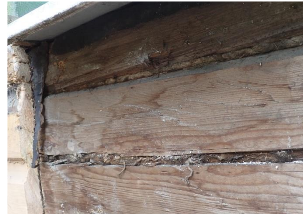
Kuva 35 Havaintojen mukaan ikkunan alapuolisessa hirressä on kosteuden aiheuttamia jälkiä.
