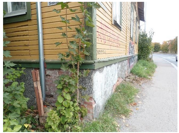
Kuva 10 Syöksytorvien vedenpurku on rakennuksen vierustalle. Rakennuksen kadun puoleinen vierusta osin asfalttia.
