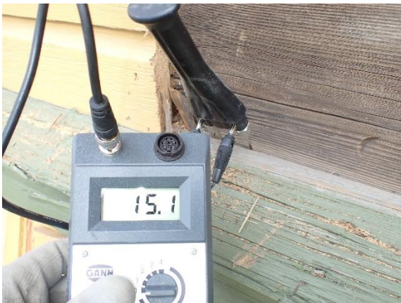
Kuva 44 Ulkoseinän alimman hirren kosteuspuitoisuus etelän puoleisella julkisivulla.
