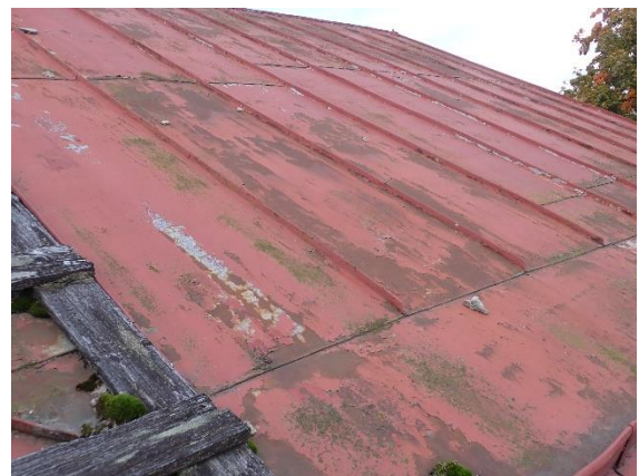
Kuva 65 Vesikatteen pellissä on ruostevaurioita.
