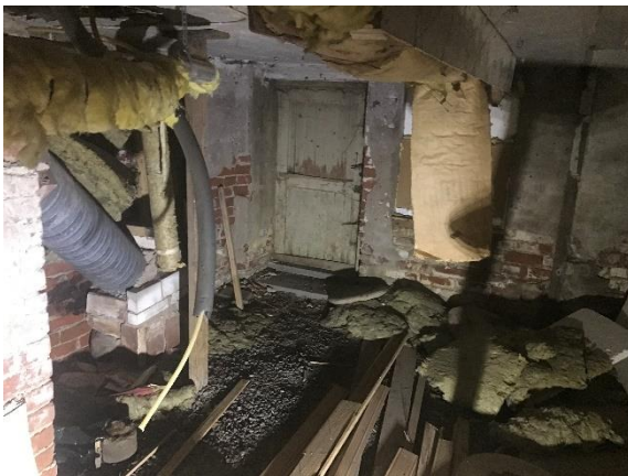
Kuva 27 Yleiskuva kellaritiloista (tila 007), tiloissa on paljon rakennusjätettä maapohjaa vasten.
