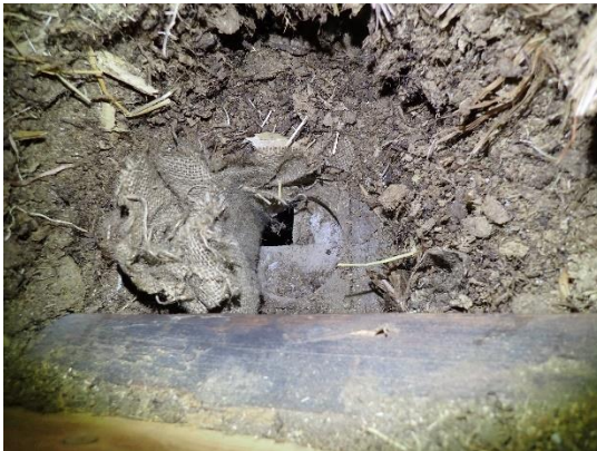
Kuva 50 Keittiössä 110 välipohjan (VP1) juuttikankaan alapuolinen laudoitus ja tikutusrappaus.
